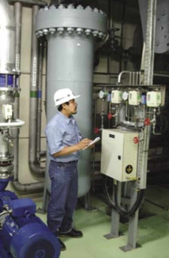
Inspección y control de Válvula Esférica / Examination and control of Spherical Valve
