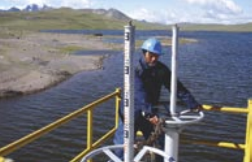
Operador de Compuerta / Floodgate Operator
