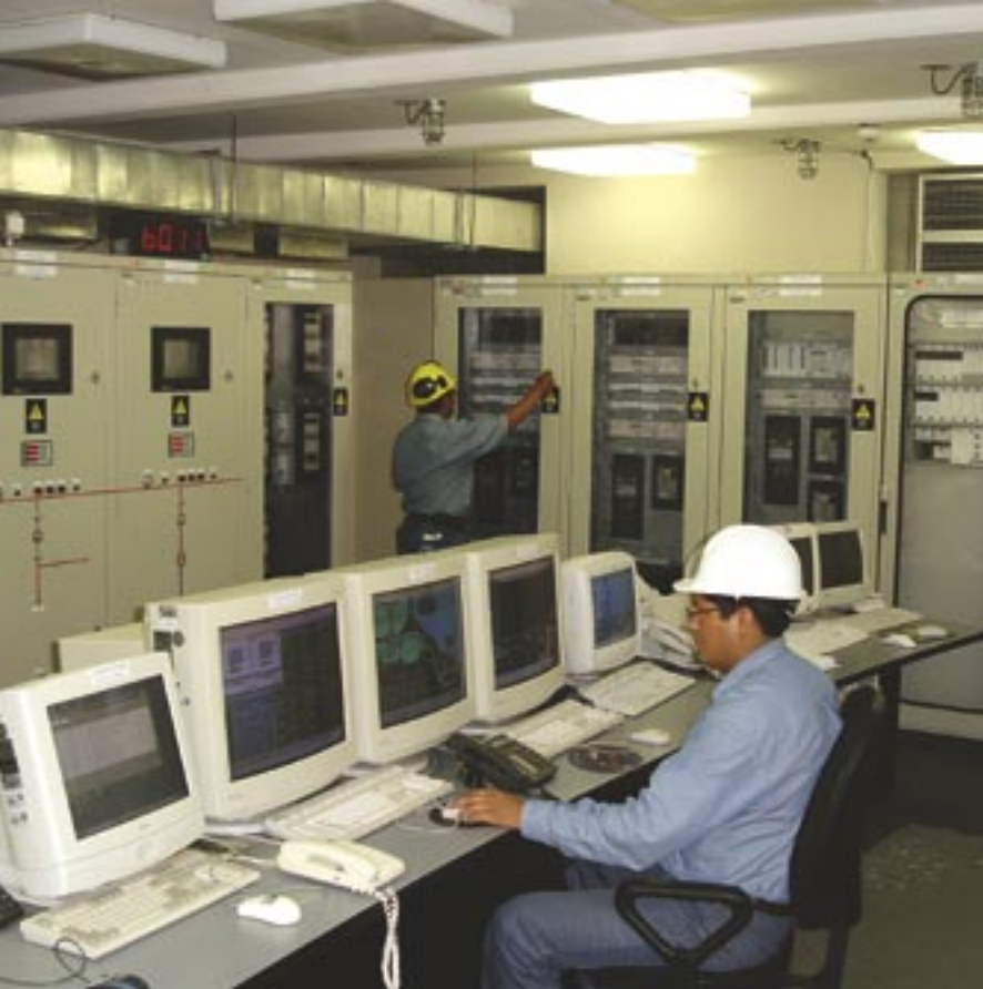
Centro de Control, Sub Estación San Gabán II / Control Center, San Gaban II Sub Station
