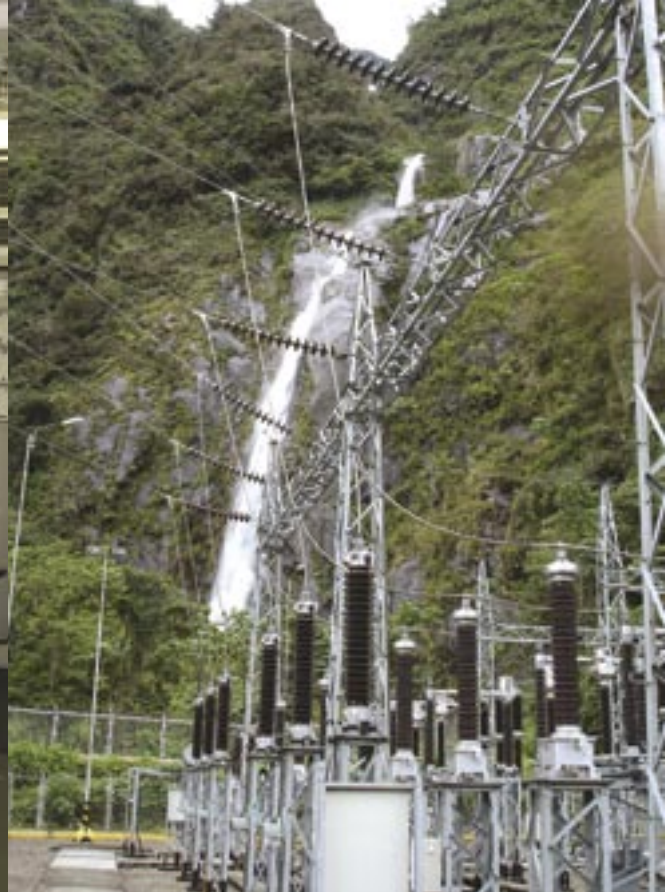
Patio de llaves, Sub Estación San Gabán II / Switchyard, San Gaban II Sub Station
