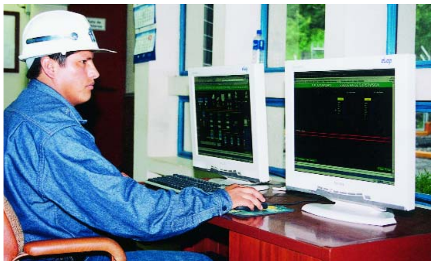
Nuevas estaciones de operación S.E. San Gabán II. New operating sub-stations. San Gaban II.
