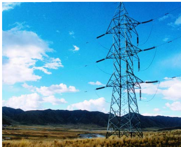
Torre de Transmisión Ayaviri Transmission Lines-Ayaviri
