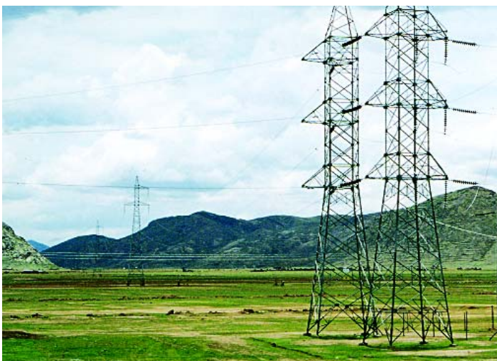
Líneas de Transmisión, Macusani. Transmission Lines, Macusani.
