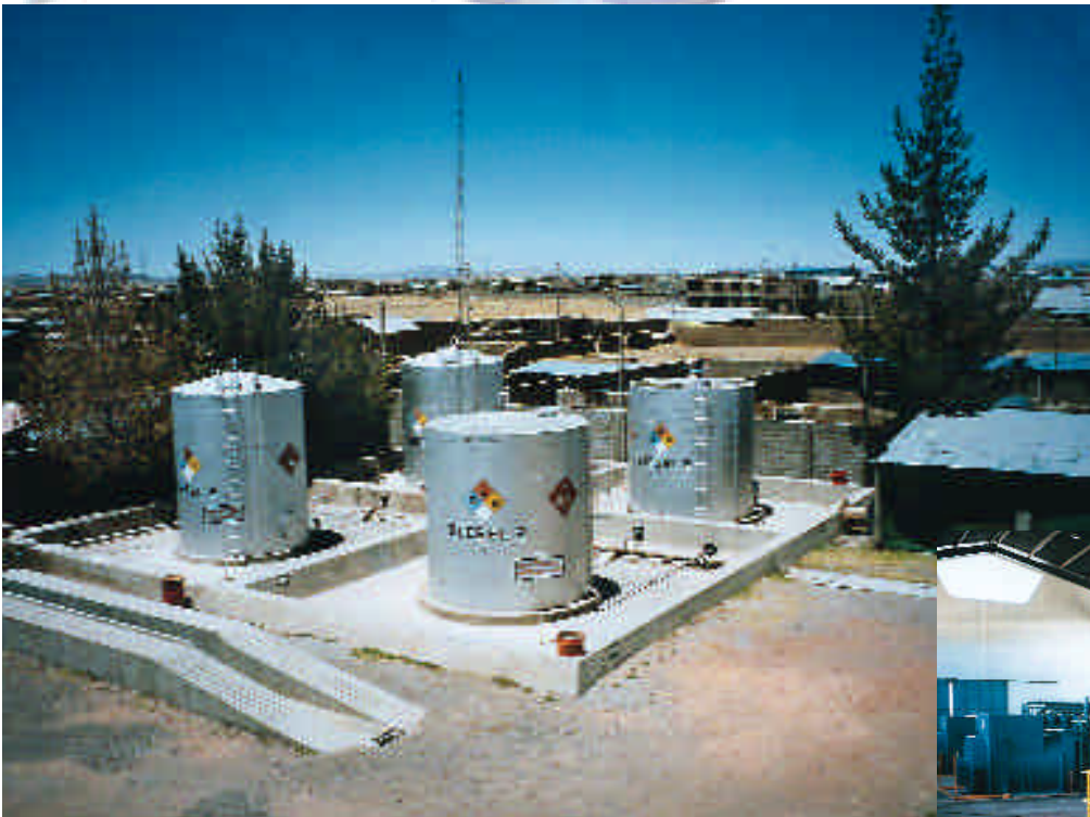
Tanques de Combustible, Planta Térmica de Taparachi (Juliaca) Petroleum Tanks, Taparachi Thermal Power Station (Juliaca)
