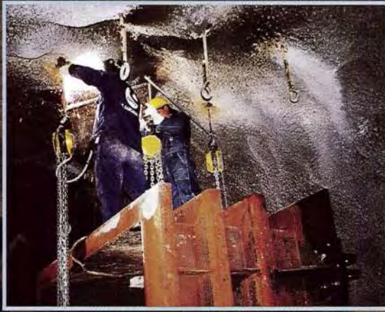
▲ Ventana Uruhuasi. Instalación del marco de la puerta blindada en el tapón. Uruhuasi's Access Tunnel. Installation of the frame of metallic gate in the drain stopper.
