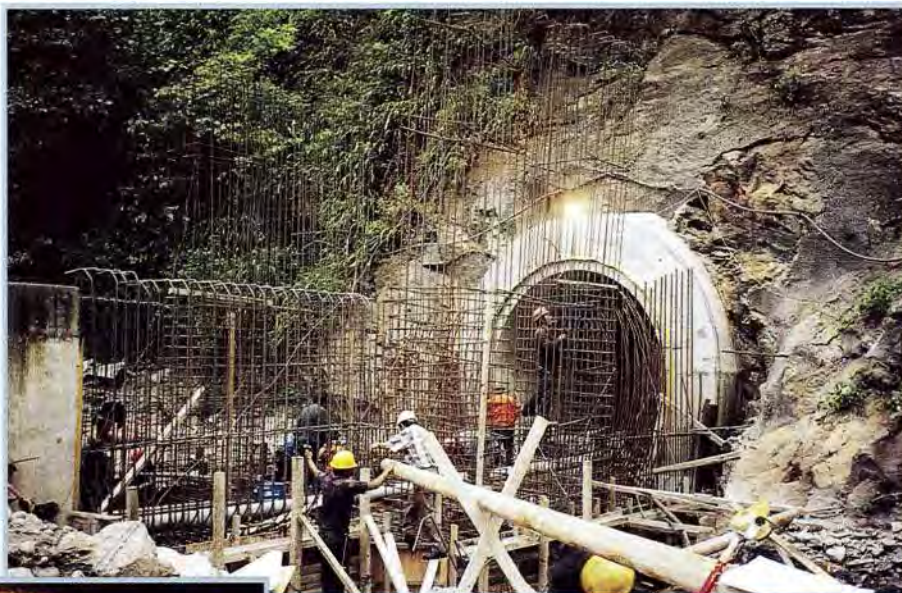
Obras Civiles del canal de descarga. Civil Works of the Discharge channel.
