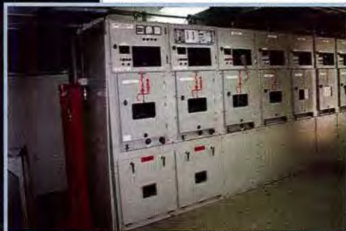
Sala de tablero de medición de servicios auxiliares. Agosto 1999. Ancillary services measurement panel. August, 1999.
