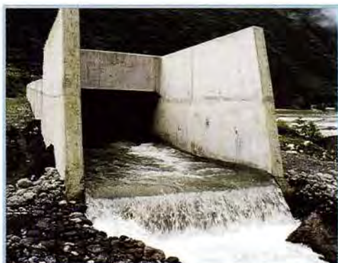
Túnel de descarga en operación. Discharge tunnel in operation.
