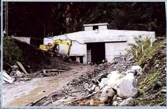
Portal de Acceso a la casa de máquinas: Vista frontal Entrance to the Power House : Face view
