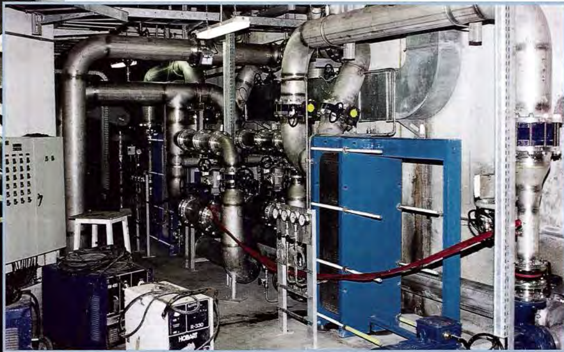
Equipamiento mecánico, electromecánico e hidromecánico de la Central. Servicio de Agua listo para pruebas. Setiembre 1999. Mechanical, electromechanical and hydromechanical equipment of the Power Station. Water installation ready for tests. September, 1999.
