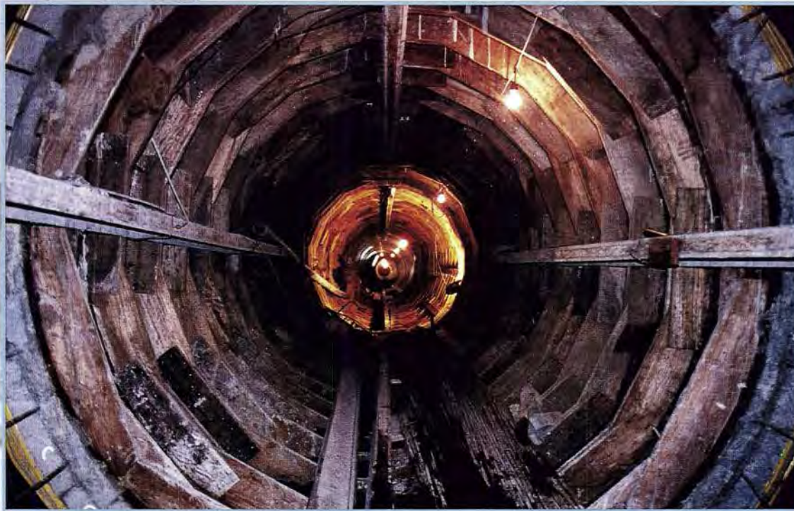
Conducto forzado. Encofrado del tramo horizontal inferior. Penstock. Inside framing of the lower horizontal section.
