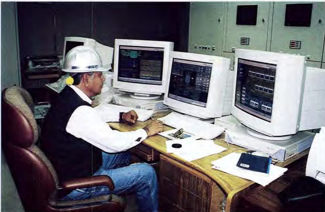
Equipos de control en Subestación San Gabán II. Sub Station San Gabán II Equipment of Control.
