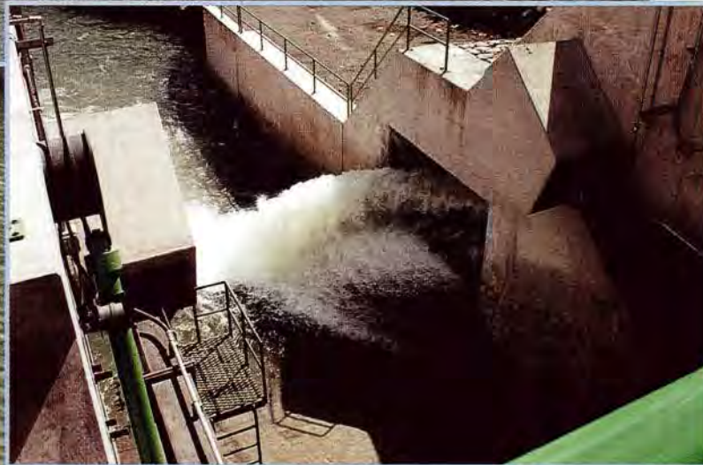
Descarga del agua por los respiraderos de la toma. Discharge of water by the intake vent.
