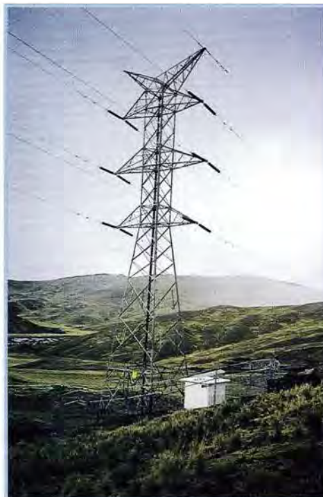
Estación repetidora de fibra óptica. Junio 1999 Fiber optic repeater station. June, 1999.
